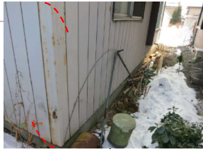
●金属系パネルのさび
