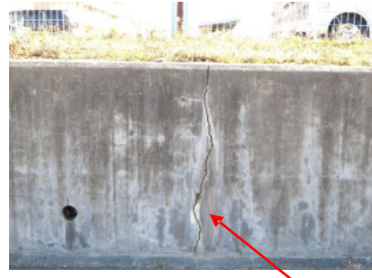
●擁壁のひび割れ
