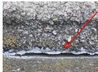
●シーリング材のはく離
