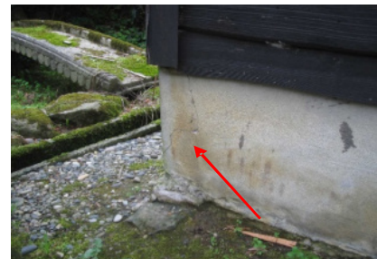
●基礎のひび割れ
