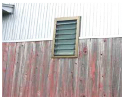
●外壁の木部塗装劣化
