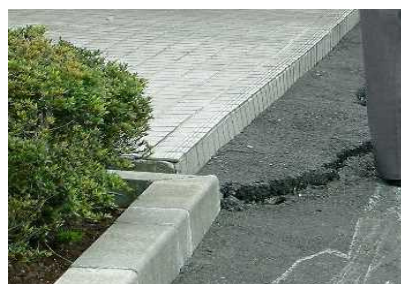
●建築物、工作物周辺の亀裂
