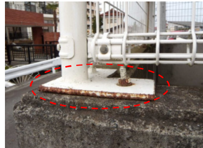
●ゴミ置場支柱柱脚の錆
