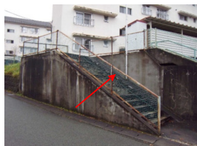
●屋外階段手すりの錆
