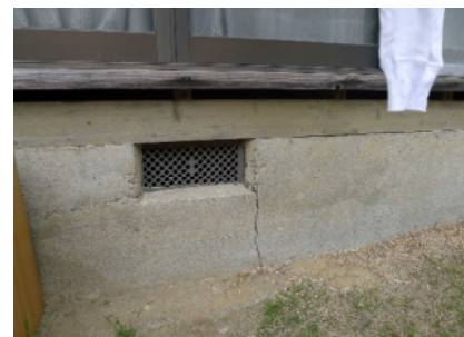
●基礎のひび割れ
