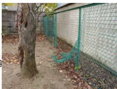
●金属フェンスの変形、破損
