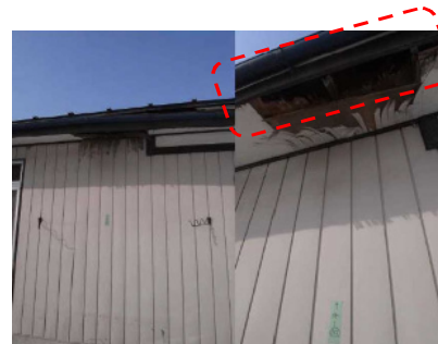
●雨樋の垂れ下がり(左)、軒天の劣化(右)
