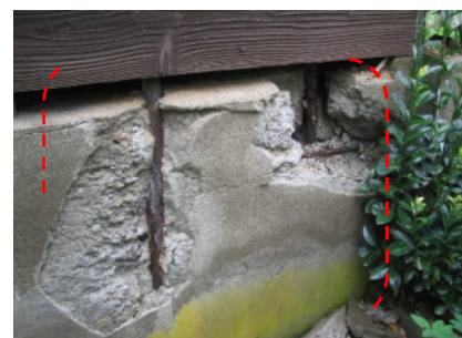
●アンカーの露出
