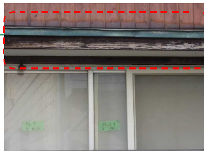
●金属屋根葺き材の腐食(さび)
