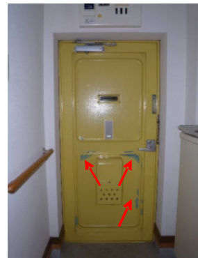
●住戸玄関ドアの塗装の剥離
