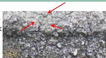
●シーリング材表面のひび割れ (防水性能上は影響なし)
