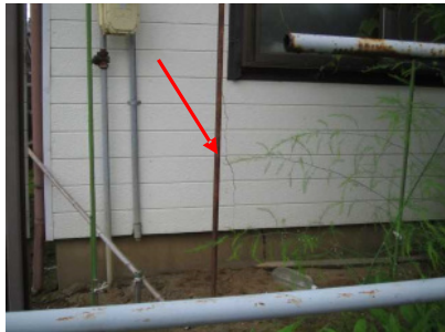
●窯業系サイディングのひび割れ
