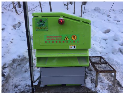
自動凍結防止剤散布装置
