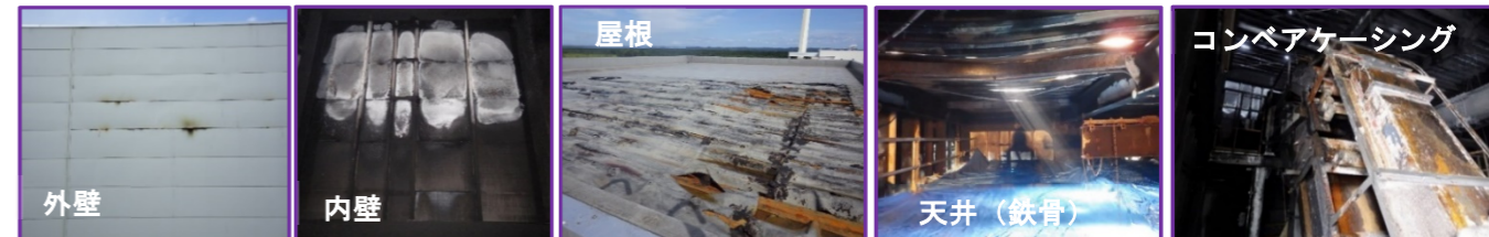
【火災1】被害状況
