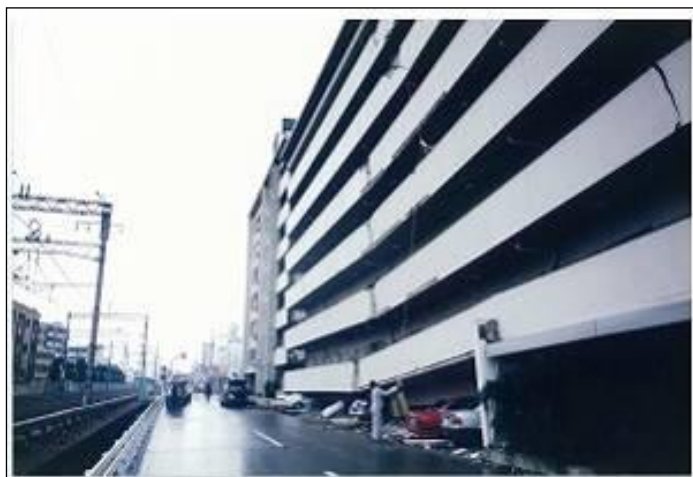
1階を駐車場などで利用するため、ほとんど壁がなく柱だけで支えている「ピロティ形式」と呼ばれる建物の1階部分が崩壊(阪神・淡路大震災) 写真：日本技術開発(株)提供
