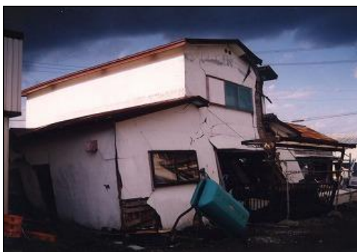
老朽化が進み、耐力壁が不足していることにより、傾いた住宅（北海道東方沖地震） 写真：北海道立北方建築総合研究所提供
