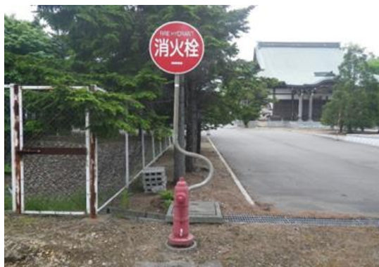
更新前の消火栓
