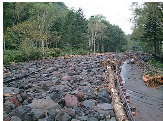
平成26年の土石流が発生した国道453号 (札幌開発建設部提供)
