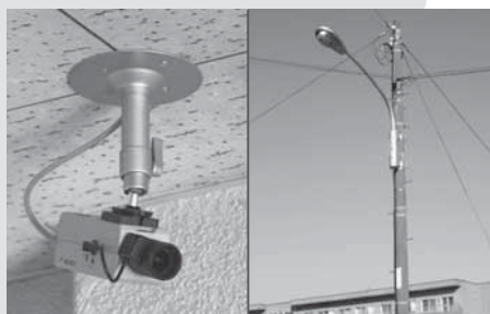
犯罪の防止を目的として新しく設置した防犯カメラ(写真左)と防犯灯(写真右)
