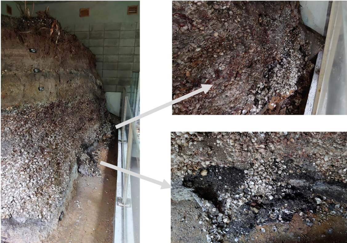
東壁崩落状況（R4. 8. 26 撮影）
