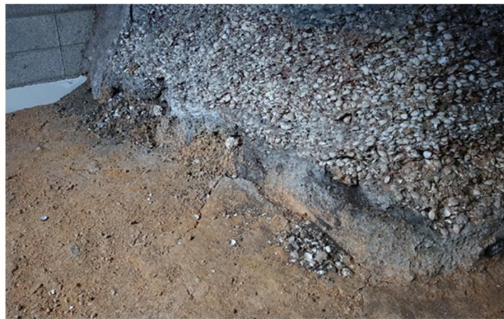
南壁崩落状況（R4. 9. 26 撮影）
