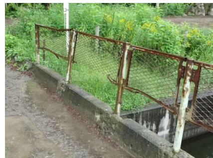
写真6 防護柵の破断
