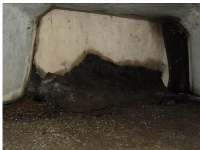
写真3 伸縮装置目地板の脱落
