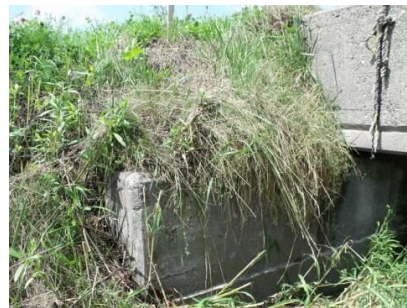
写真2 沓座の土砂堆積
