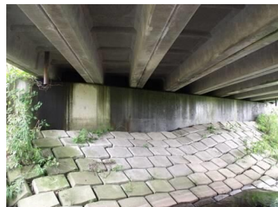
写真4 伸縮装置からの漏水
