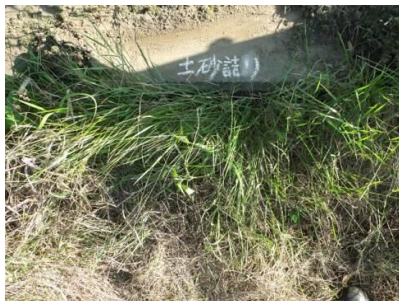
写真1 排水桧の土砂詰り
