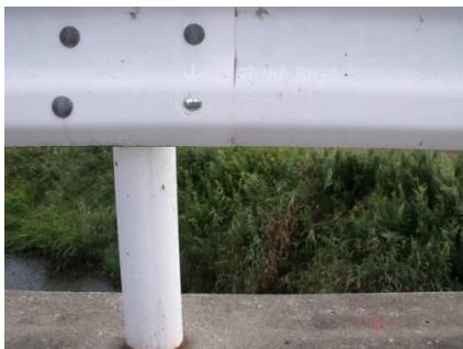
写真5 防護柵ボルトの脱落
