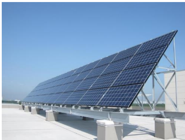
太陽光発電設備（10Kw × 1基）
