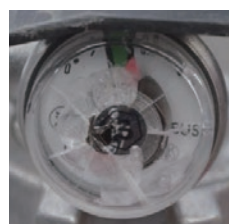
× 指示圧力計の損傷
