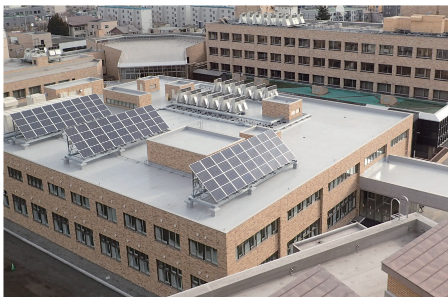
千歳市役所第2庁舎の太陽光パネル
