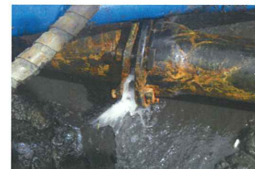
老朽化した水道管からの漏水
