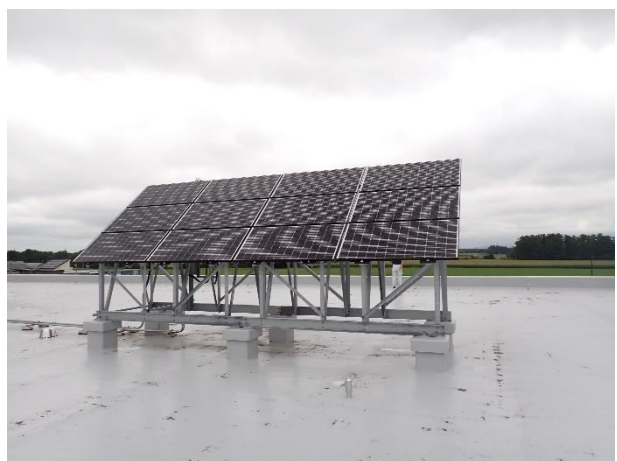
既設太陽光パネル
