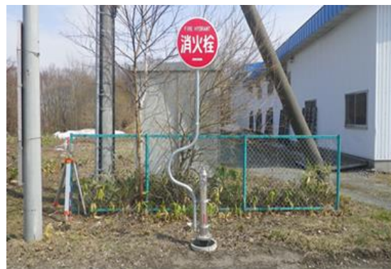
更新後の消火栓
