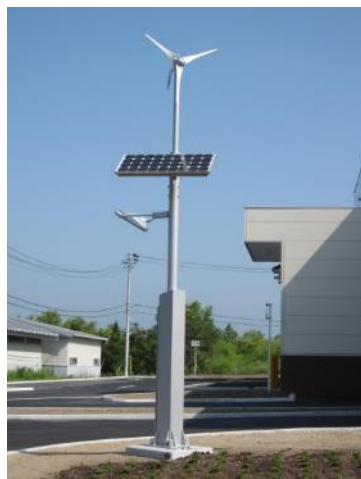
太陽光風力発電 LED 外灯（9W × 2基）
