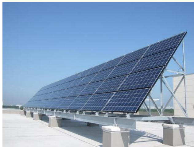
太陽光発電設備（10Kw × 1基）
