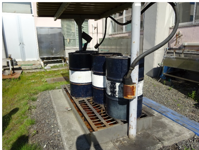
③-1 廃油保管が屋外露出
