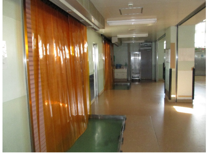
⑩配送前室と洗浄室の間仕切が開放状態
