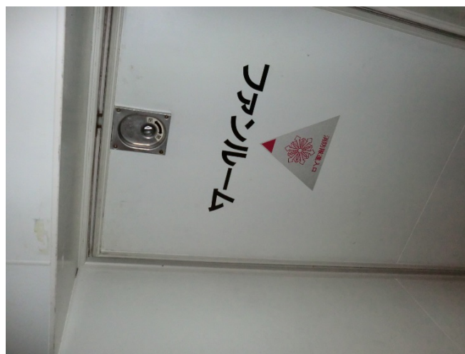
⑯ 2階ファンルームへの動線が天井収納トラップ
