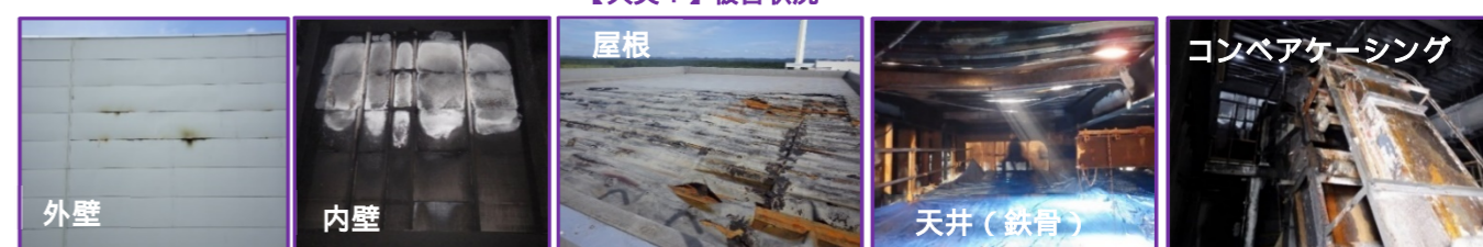
【火災1】被害状況
