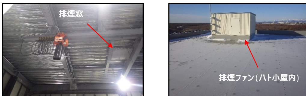
写真 11 . 排煙設備の設置状況
